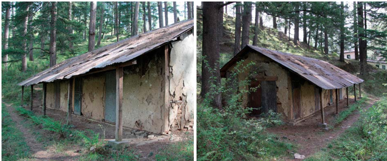
Хозяйственная постройка, находящаяся в аварийном состоянии
